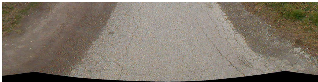
Videoaufnahme einer beschädigten Oberfläche © AIT
