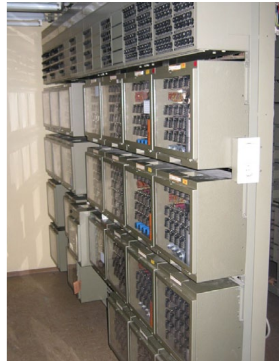
Relaisstellwerk Siemens in der Betriebsstelle Bruck an der Leitha - Bild: Herwig Leutgoeb
